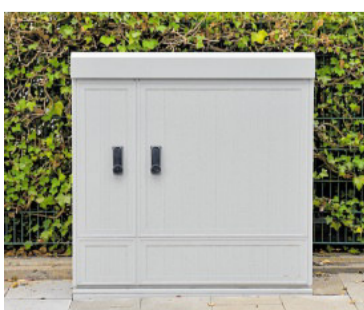
40 solch moderner Verteilerkästen stehen 2017 in Wetter. FOTO: H.W.RIECK
